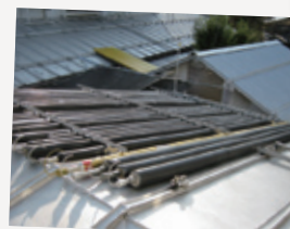
屋根に設置された太陽熱温水器
