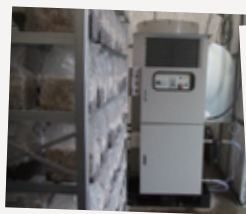
地下水熱ヒートポンプ
